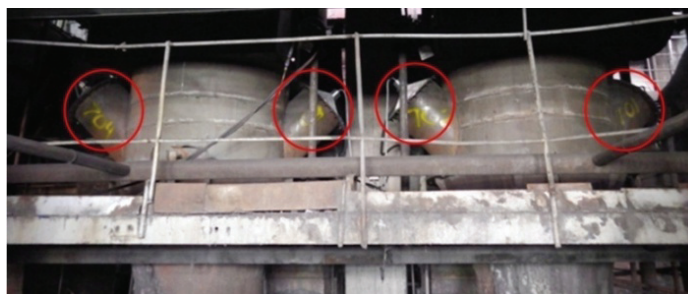
Рис. 5. Фото установленных УЗ-излучателей в трубы Вентури золоулавливающей установки
